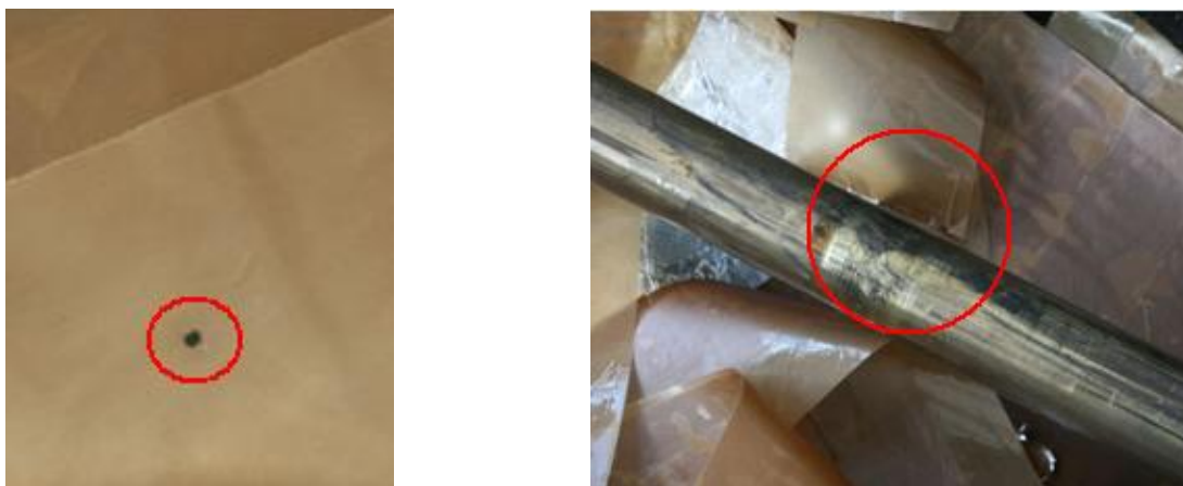
Рисунок 8 Следы ЧР в изоляции ввода
